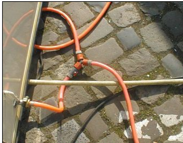
Abbildung 2: Beispiel für eine unsachgemäße Trinkwasserinstallation. Weder Schläuche noch Verbindungsstück genügen den Anforderungen
